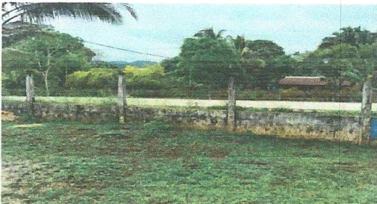
Foto 4: Se observa el deterioro de la estructura portante, desprendimiento de pintura del muro perimetral
